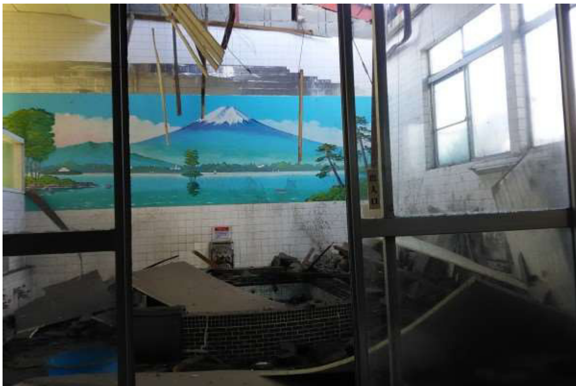
平成 28 年 (2016 年) 熊本地震本震後の浴場
