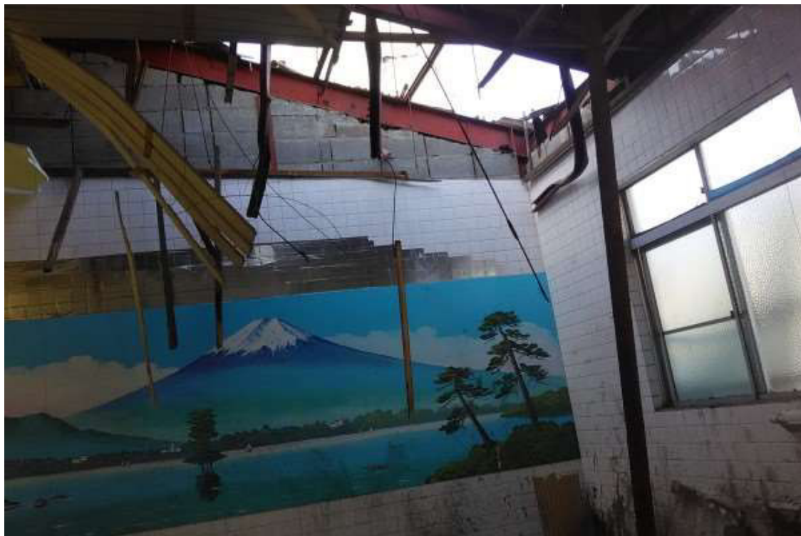
煙突が折れ、天井は落ち、ボイラー使用不能
